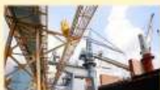
Hệ thống đường ống và băng tải rộng khắp
