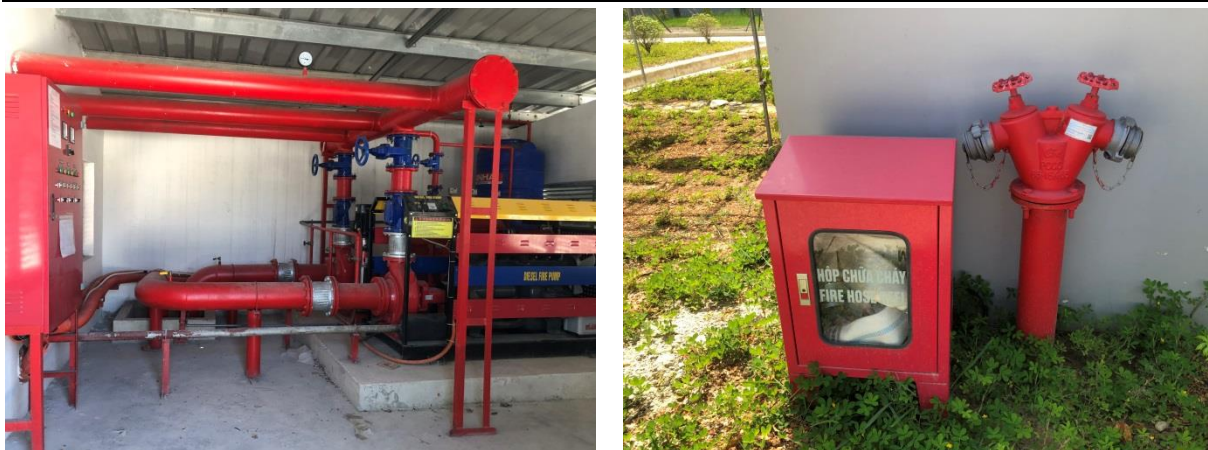
Hình 3.20. Các công trình PCCC đã được lắp đặt tại dự án
