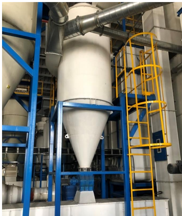
Hình 3.11. Hệ thống thu bụi tại máy ép viên
