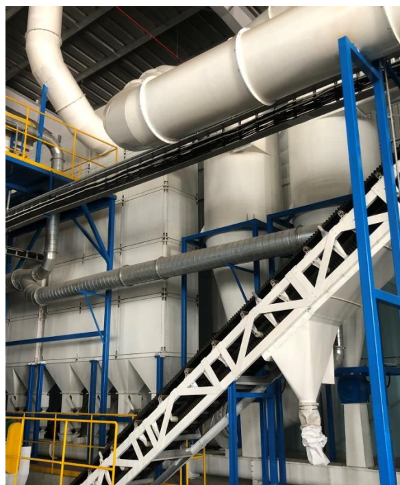
Hình 3.12. Hệ thống thu bụi tại hệ thống làm nguội
