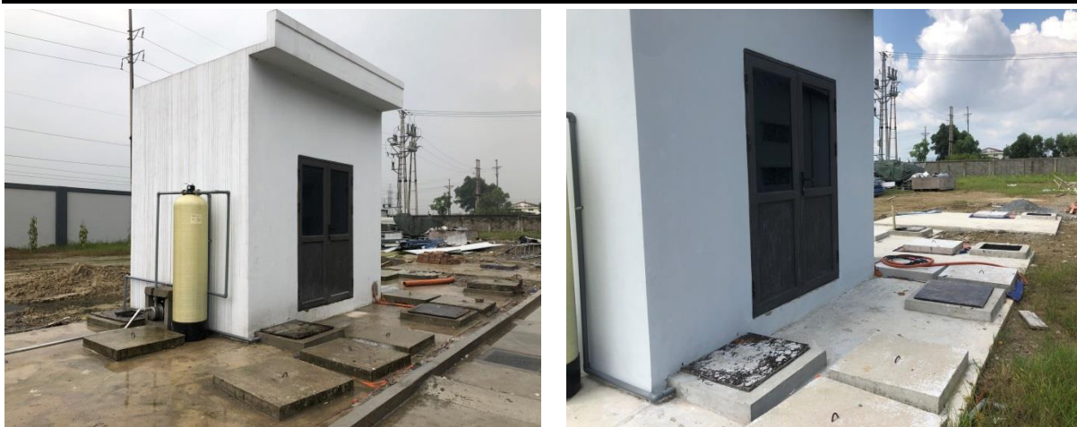
Hình 3.7. Hệ thống xử lý nước thải đã xây dựng tại nhà máy
