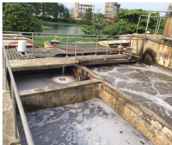
Hình 3.8: Các bể xử lý nước thải đang hoạt động
